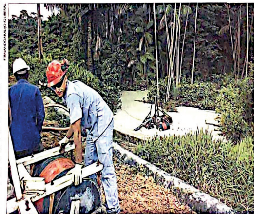
Funcionários da mineradora são mobilizados para controlar o vazamento
